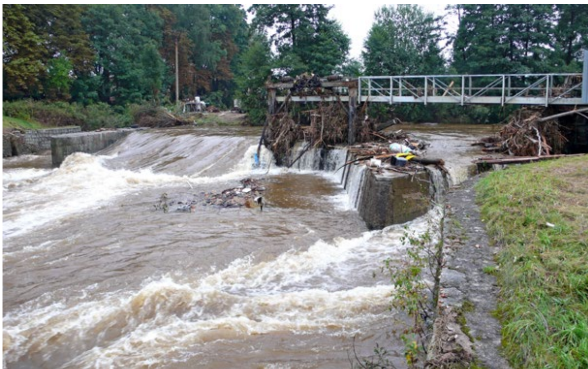
Obr. 10.9 Jez na dolním okraji Frýdlantu po povodni roku 2010. Jez, navíc s obstarožní obslužnou konstrukcí, na níž vznikla bariéra spláví, podle všeho působením zpětného povodňového vzdutí zhoršil dopad povodně na město.
