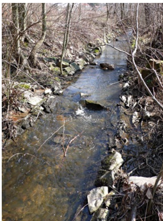
Obr. 8.26 Stará úprava potoka s opevněním dlažbou na sucho. Dlažba se rozpadá, koryto tím nabývá na členitosti. Další renaturaci by bylo možné podporovat místním narušováním dlažby a vkládáním změlčujících a rozčleňujících struktur kameniva a říčního dřeva.
