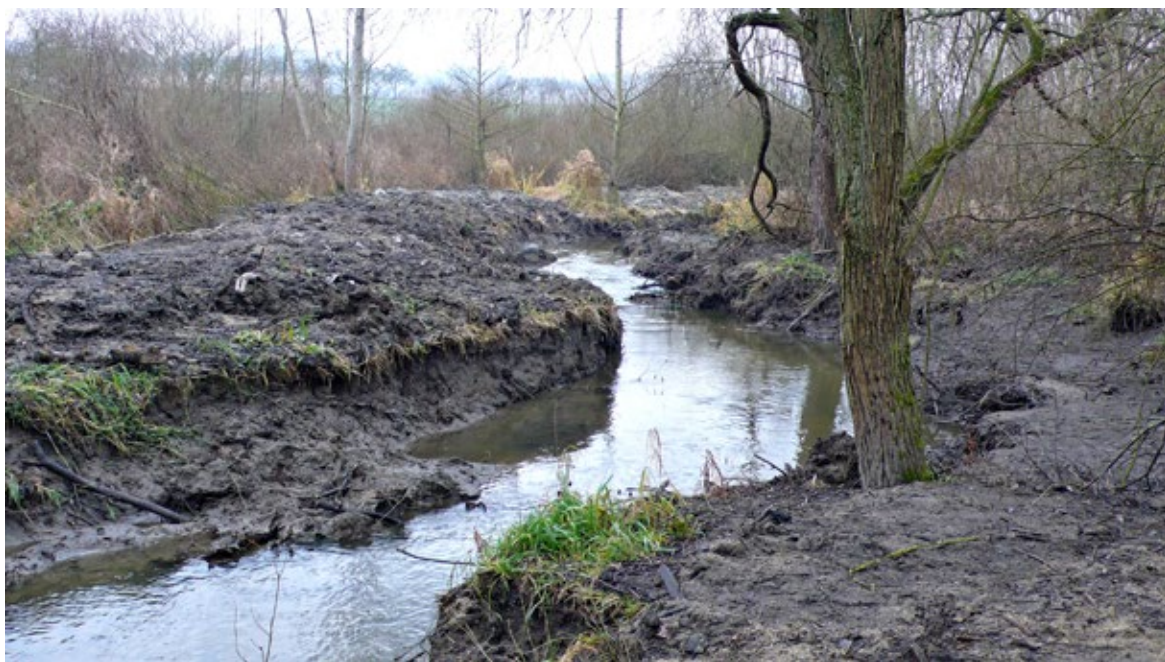
Obr. 11.2 Devastační těžení sedimentů a jejich „rozkydávání“ kolem koryta představují dnes nepřipustné postupy. Poškozují vodní tok i jeho okolí. Lze formulovat zásadu: „Když nemáš zajištěné regulérní využití nebo zneškodnění sedimentů, do koryta se vůbec nepokoušej hrabat!“
