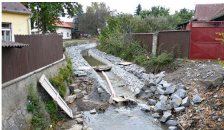
Obr. 10.10 Zpoždění o 50 let a poslední pomsta rušené Zemědělské vodohospodářské správy? Protipovodňová úprava Chumavy v Hostomíciích na Berounsku, prováděná kolem roku 2010. Lze se dohadovat, zda dlážděná vestavba do koryta ještě nezmenšila povodňovou průtočnou kapacitu. Nepochybně však geometrická, tvrdě technicky opevněná stavba, postrádající základní členitost, je velmi vzdálená dnešní představě o „ekologickém minimu intravilánového koryta“.
