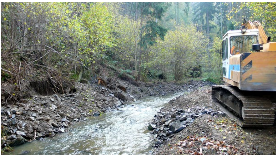
Obr. 11.1 Z rutinních důvodů prováděná, objektivně nepotřebná a fakticky škodlivá „popovodňová prohrábka“ lesního úseku potoka. Provádění prací v korytě vodního toku může působit jeho morfologickou degradaci – stírat přirozené tvary a členitost. Působí přímou mechanickou devastaci říční bioty a může ji poškozovat dalšími vlivy, jako vytvářením zákalů. Nezabezpečenými přesuny techniky a vybavení může být – s fatálními dopady na domácí populace raků – přenášen račí mor. První zásada: Zejména do morfologicky a přírodně hodnotných úseků toků zasahovat co nejméně.
