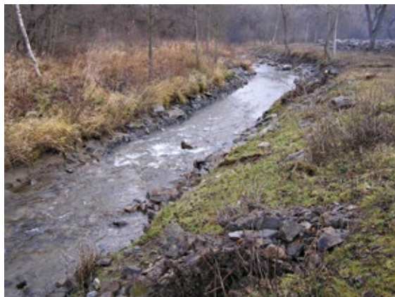
Obr. 33 Polečnice pod Kájovem před revitalizací. Morfologicky degradující technická úprava ve špatném stavu. (Foto V. Šámal)
