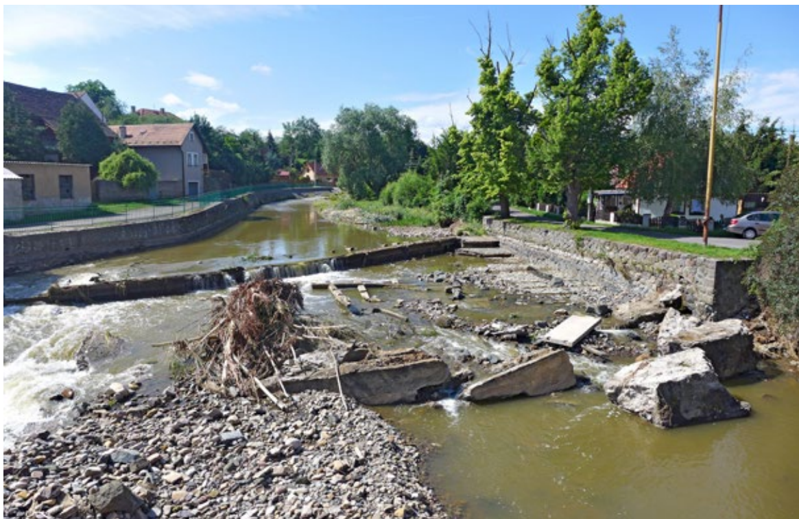
Obr. 8.17 K renaturacím mohou náležet i povodňové destrukce příčných staveb. Vzácná povodeň na jaře suchého roku 2018 zbořila jez v Lochovicích na Litavce. Trosky (v popředí vpravo) následně nechal správce toku odstranit, jez nebyl obnoven a na jeho místě zůstal na dožití starodávný nízký dřevěný jízek, který se při této události obnažil. Zjevně se zlepšily podmínky průchodu dalších povodní obcí a migračně se propojily dva několikakilometrové úseky říčky.
