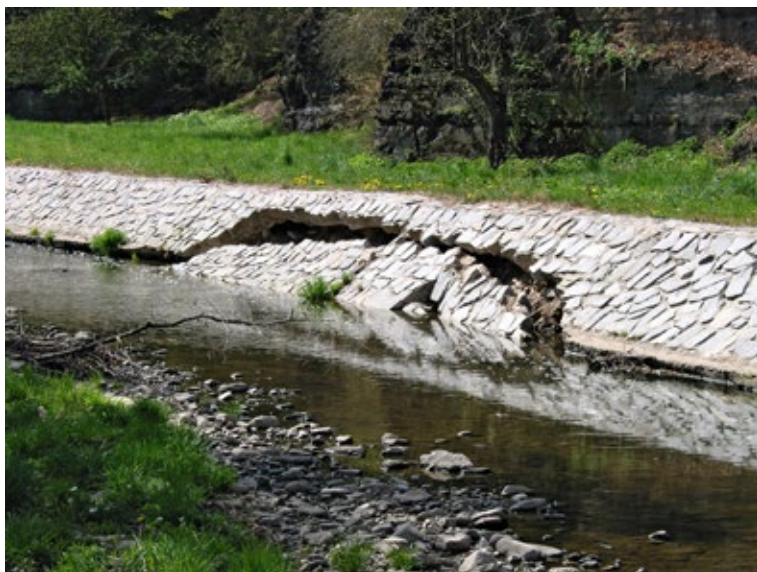
Obr. 10.51 Tuhé, netvárné konstrukce se nepřizpůsobují tvárnějšímu zeminnému prostředí. Jejich schopnost ustát nekvalitní založení a provedení je omezená. Litavka v Rejkovicích na Příbramsku byla po povodni roku 2002 opatřena tuhou dlažbou do betonu nejen nepřiměřeně a neúčelně, ale podle všeho také nekvalitně. Snímek poškození dlažby pochází z roku 2007.
